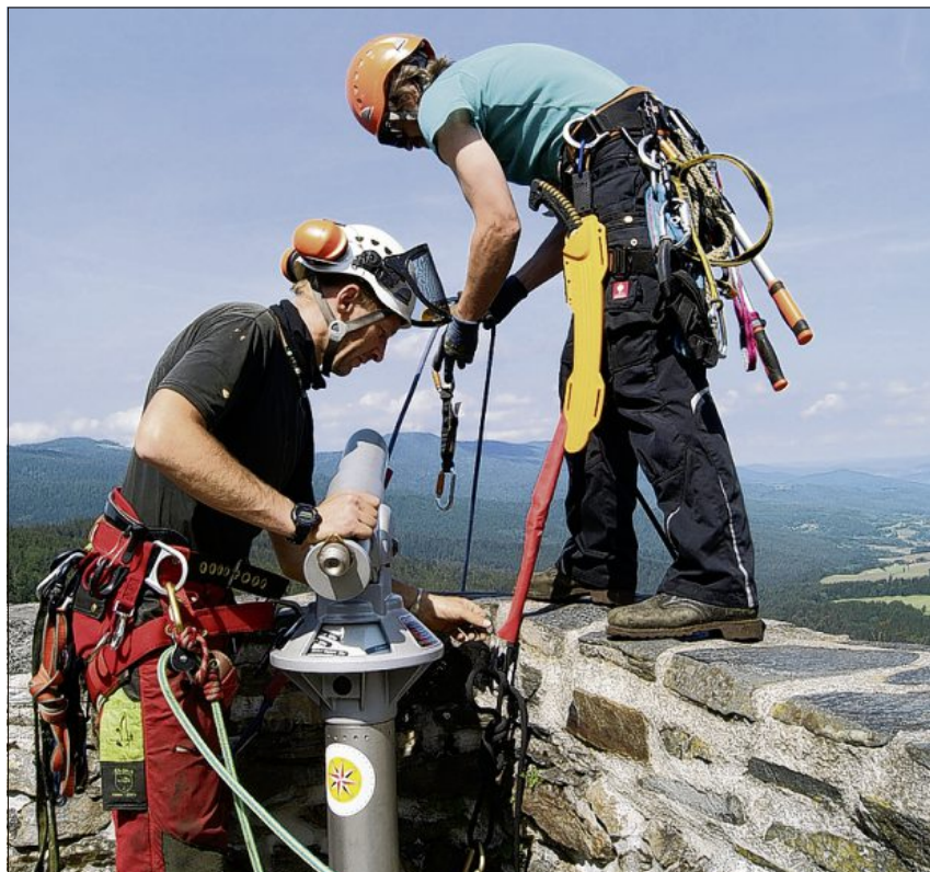
Die Profis trafen zunächst alle sicherheitsrelevanten Vorkehrungen, bevor sie mit der Arbeit im Seil begannen.
